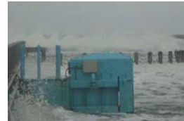
振動水柱型波力発電
